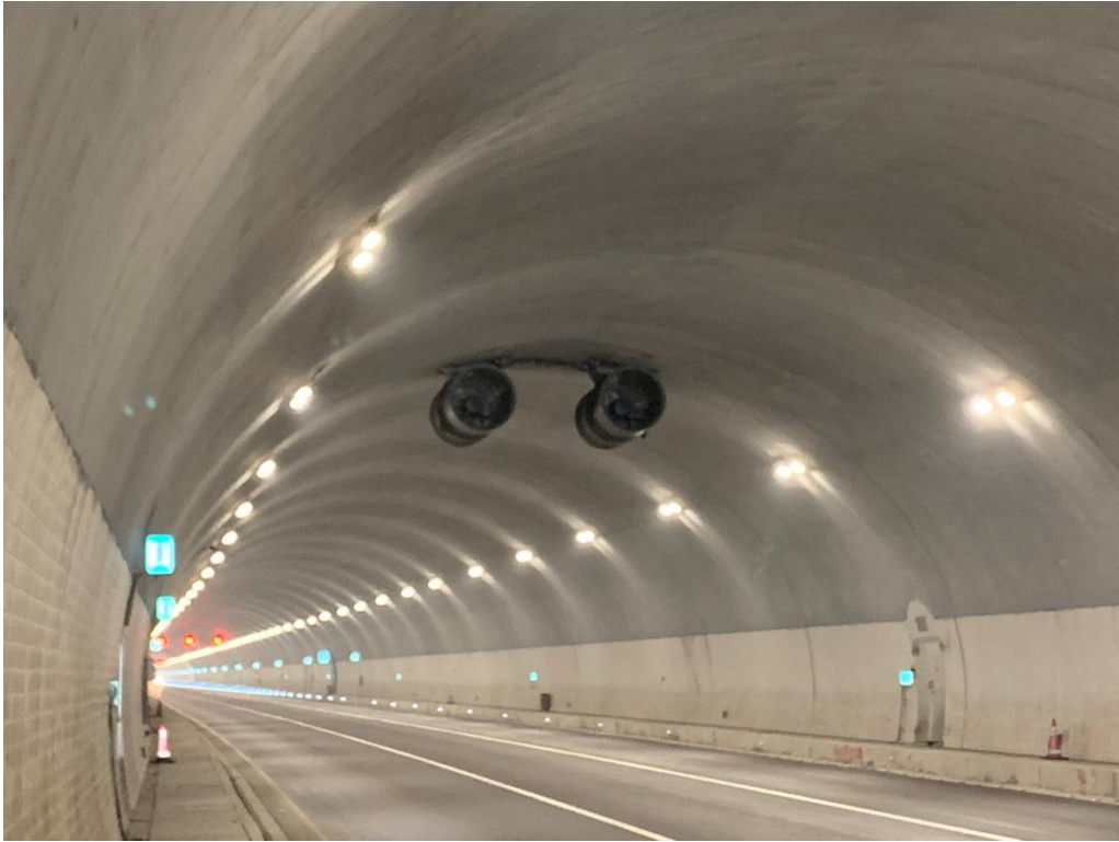
图7.4-1 本项目隧道风机
